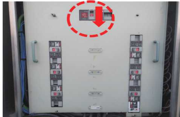
[전기시설 분전반 누전차단기 수동차단방법]
